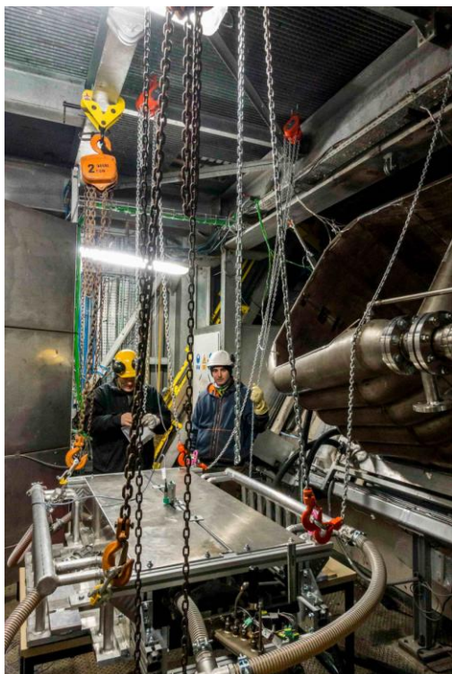
Figure 78 – Préparation des palans pour la mise en place de l'ensemble module / support / panneaux réfrigérés en fond de cavité.
