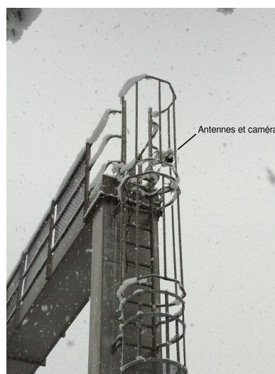
FIGURE 3.3 – Neige sur les antennes
