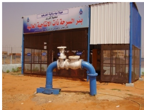
Photographie 34 : Forage-relai (profondeur 70m) alimenté par un générateur, pour la desserte d'environ 70 blocs à Al Thawra, Omdurman
