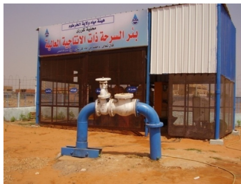
Photographie 34 : Forage-relai (profondeur 70m) alimenté par un générateur, pour la desserte d'environ 70 blocs à Al Thawra, Omdurman
