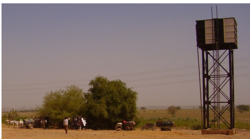
Photographie 43 : Point d'eau local et réservoir surélevé inutilisé
