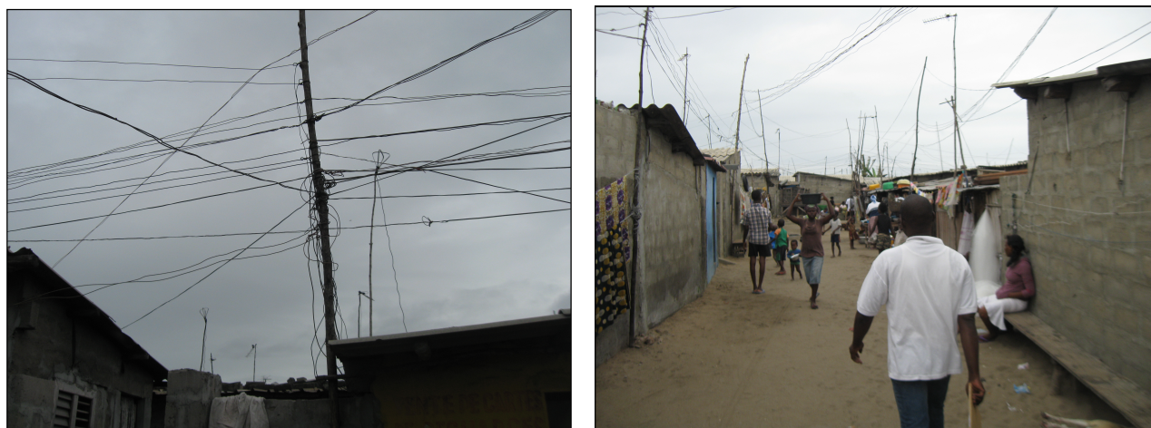
Photo 19 : Fils électriques en toile d'araignée dans le quartier Enagnon
