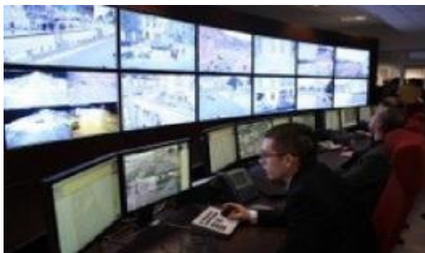
Mur d'écran du centre de supervision urbain
