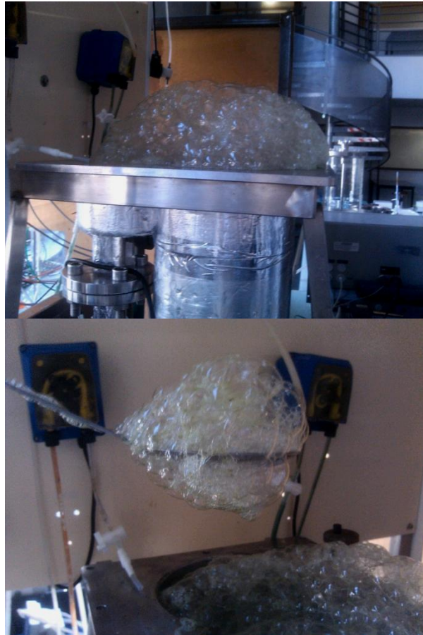
Figure 25 : Photographies de la mousse que l'on rencontre lors de l'apparition de phénomènes de lyse cellulaire. La persistance de la mousse peut être observée, elle pose beaucoup de problèmes, notamment d'écoulement dans les tuyaux. Photos prises à l'occasion d'un nettoyage du réacteur (le faisceau de fibres a été retiré)
