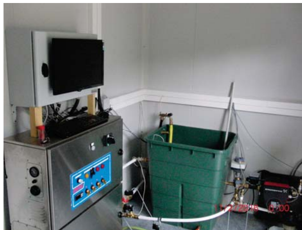
Figure 4.6: Vue de la chaudière, de l'ordinateur de pilotage et de la cuve tampon
