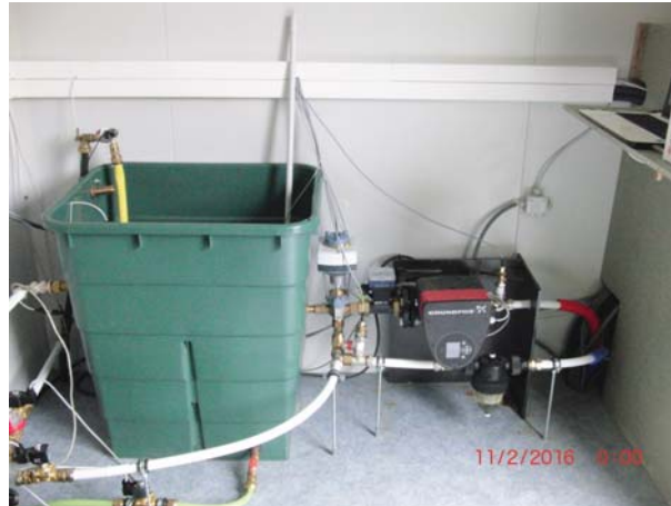
Figure 4.7: Vue de de la cuve tampon, de la vanne « 3 voies », du débitmètre, du circulateur et du filtre
