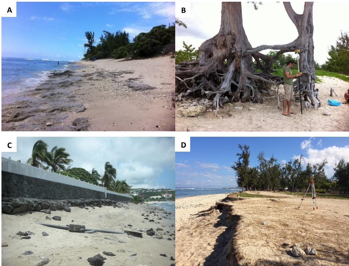
Figure 3-23: Marqueurs d'érosion des plages dans le paysage. A: affleurement de beach-rock en pied de plage; B: filaos déracinés sur la plage de l'Ermitage; C: affouillement de murs dans le secteur des Roches Noires; D: talus d'érosion dans la partie nord de l'Ermitage
