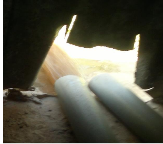
Photo 2 : eau turbide à la sortie d'une chambre de filtration à Baloom
