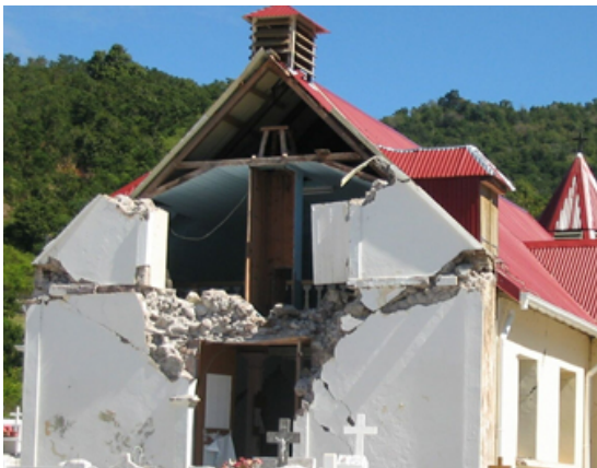
(a) Église de Terre de Bas (Les Saintes) après le séisme du 21 novembre 2004 ( Bureau Central Sismologique Français, 2005 ).
