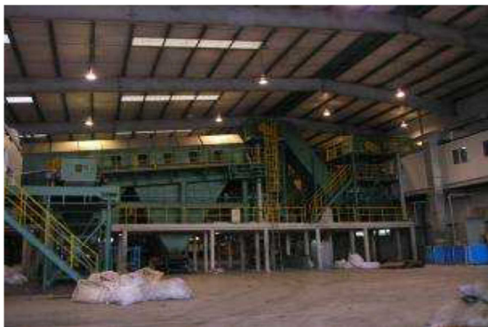
Ligne de traitement
