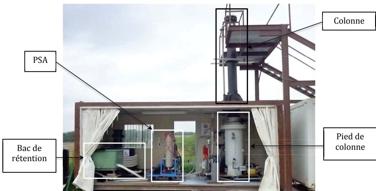
Figure 2.23 : Présentation des éléments de l'installation dans la salle de procédé
