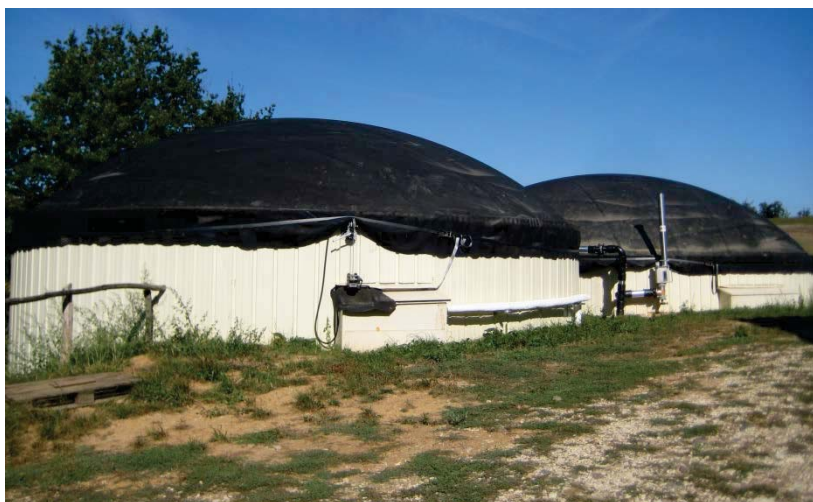
Figure 1.3 : Digesteur en voie liquide continue (Crédits photos : société Aria Energie – GAEC de Jammes (15))
