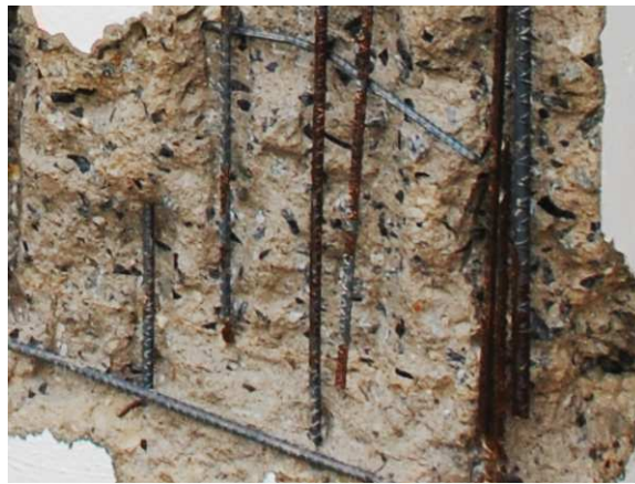
FIGURE A.6 – Les armatures du béton armée apparaissent et le béton s'est écaillé.
