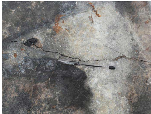
FIGURE A.2 – Développement d’un réseau de fissure dans une dalle en béton suite à un feu [124].
