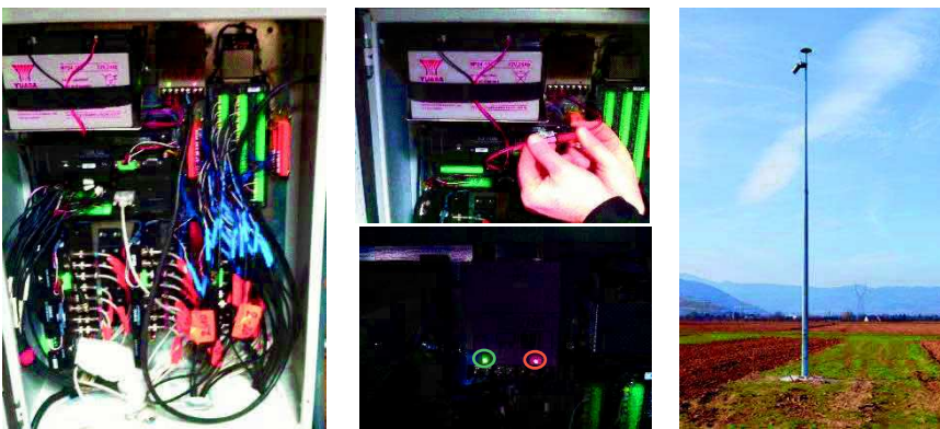
Image VIII : Branchements effectués dans la centrale d'acquisition CR1000 et connexion au panneau solaire situé sur un mat.
