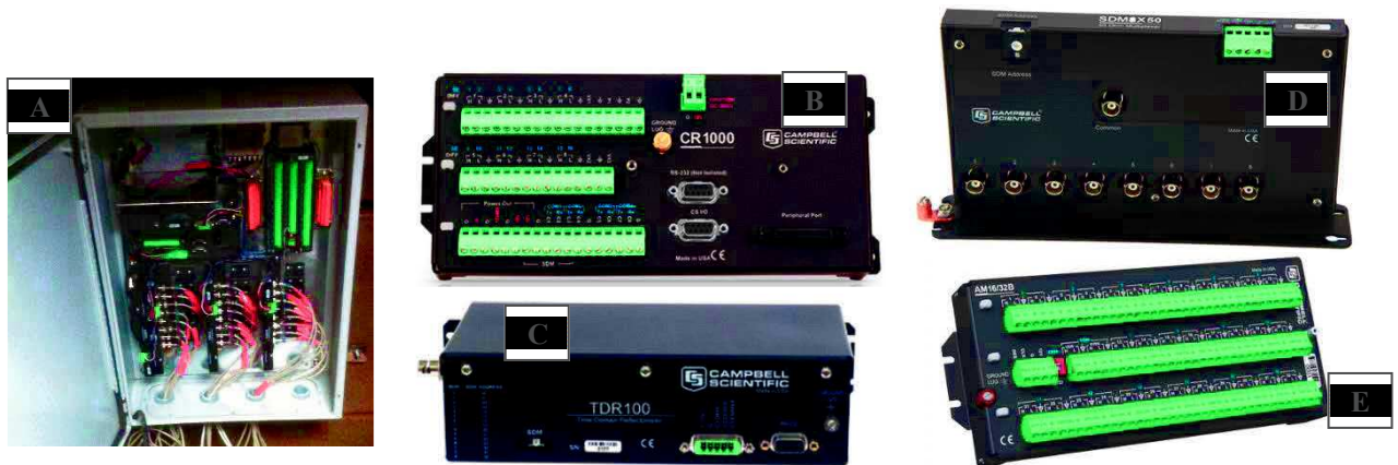
Image VII : Coffret contenant la centrale d'acquisition CR1000 et les différents modules associés qui permettent le raccordement de l'ensemble des instruments de mesure (tensiomètres, sondes TDR et thermistances).
