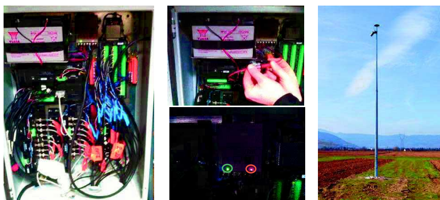
Image VIII : Branchements effectués dans la centrale d'acquisition CR1000 et connexion au panneau solaire situé sur un mat.
