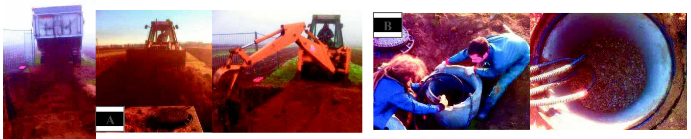
Image VI : Rebouchage de la fosse d'instrumentation et mise en place des regards en bordure de parcelle pour les instruments de surface.
