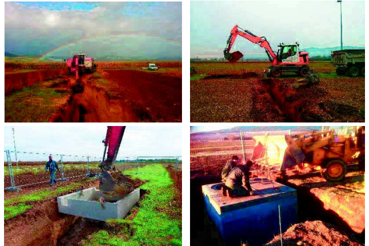
Image 2.5 : Ouverture de la fosse d'instrumentation et pose du regard en béton où sont acquises les données instrumentales.
