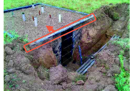
Image 4.10 : Instrumentation de la Case 4 et profil concerné par le décalage et les écoulements préférentiels associés.
