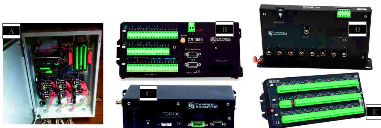
Image VII : Coffret contenant la centrale d'acquisition CR1000 et les différents modules associés qui permettent le raccordement de l'ensemble des instruments de mesure (tensiomètres, sondes TDR et thermistances).
