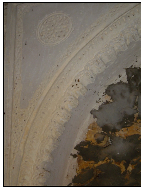
Fig. 194 : Arc en plâtre - détail
