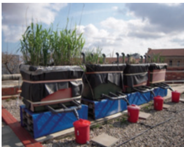
Figure 4-19 : Lits de séchage plantés de roseaux expérimentaux pour le traitement des boues résiduaires (Argilaga, 2011)
