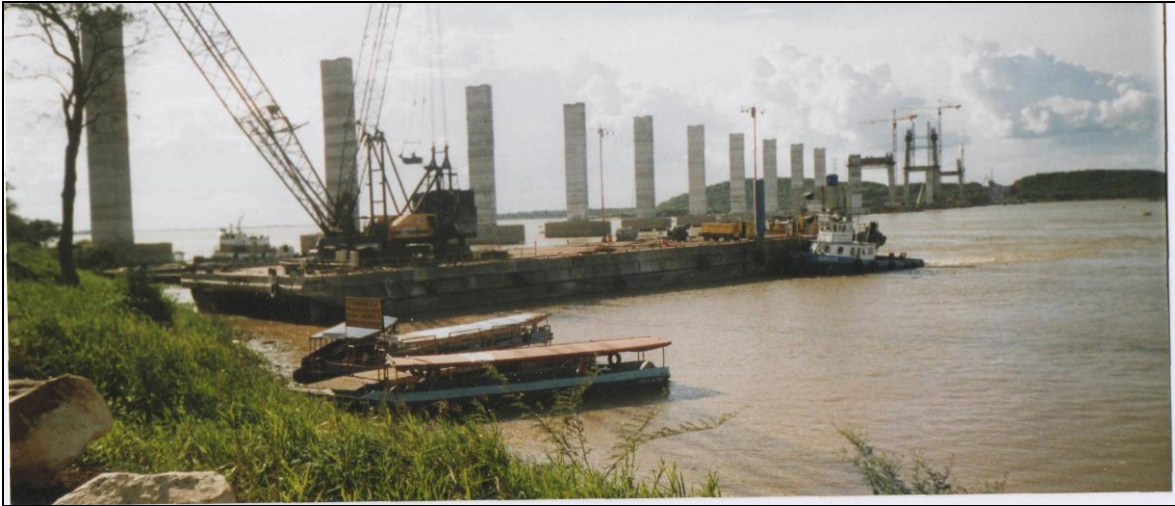
Photographie n 14 : Le pont Orinoquia , en construction, pris depuis la rive droite.
