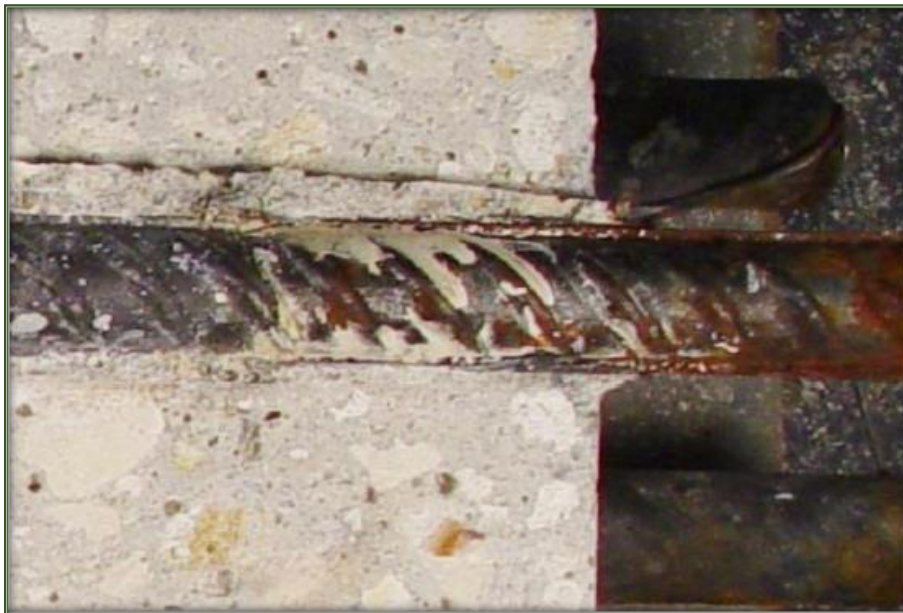
Fig. 69. Corrosión de la varilla de acero en la interface varilla-concreto-ambiente (Hartt, 2016).
