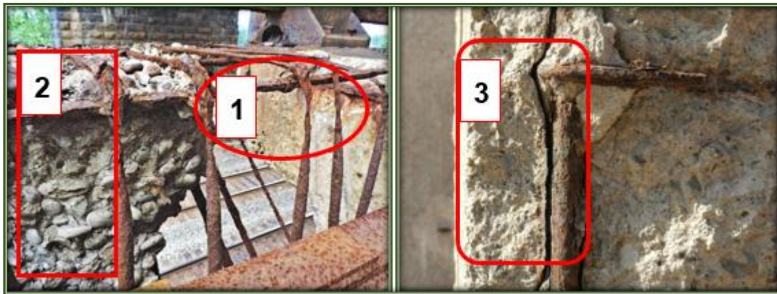
Fig. 1. Consecuencias desencadenadas tras el proceso de corrosión de las varillas de acero de refuerzo embebidas en concreto ( http://www.enriquealario.com/carbonatacion-de-hormigon/#lightbox/0/ ).
