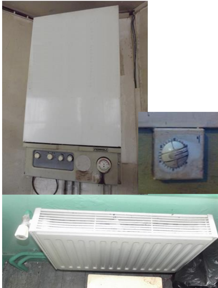
Figure 72 : chauffage central à gaz et émetteur à eau
