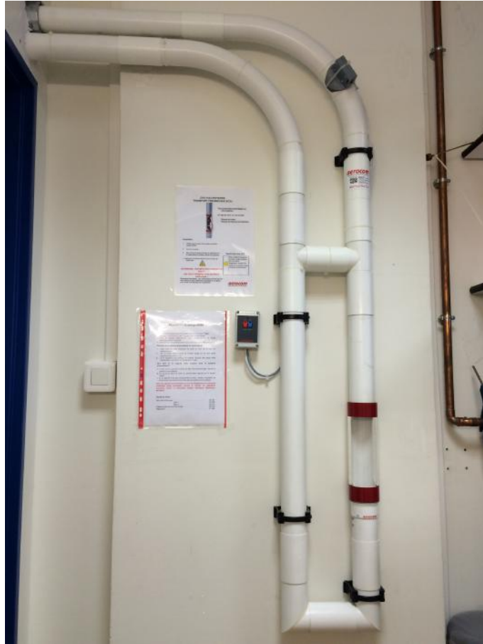
FIGURE 5.1 – Système pneumatique reliant le bloc opératoire de Neurochirurgie à la salle du spectromètre. Hôpitaux Universitaires de Strasbourg, Hôpital de Hautepierre.
