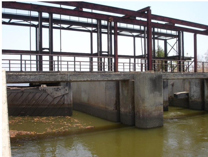
Photo 25 : Le barrage dégradé de Guidel sur le site de Niaguis
