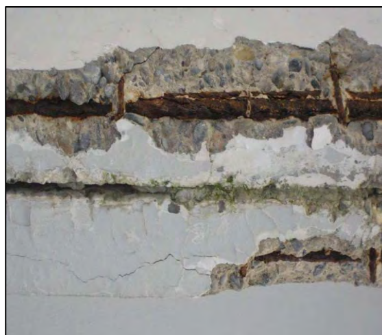
Figure I. 3 : Eclatement du béton d'enrobage dû à la carbonatation [Vu, 2011].
