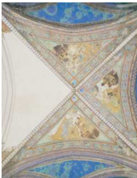
Figura 82. Volta del transetto della Basilica Superiore d'Assisi dopo il terremoto del 26 settembre 1997
