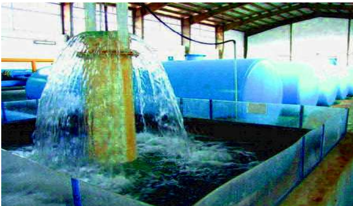
Photo 8 : Recyclage de l'eau: http://www.ilna.ir
