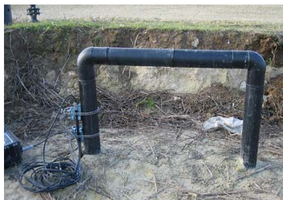
Débitmètre à ultrasons sur le collecteur principal
