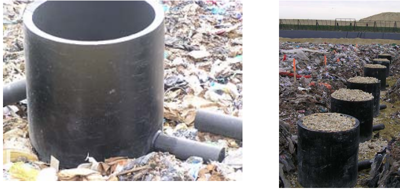
Figure 92 : Photos des lysimètres installés
