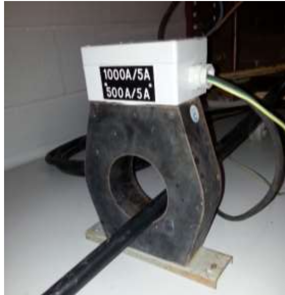
Figure 38 : Transformateur de mesure de courant
