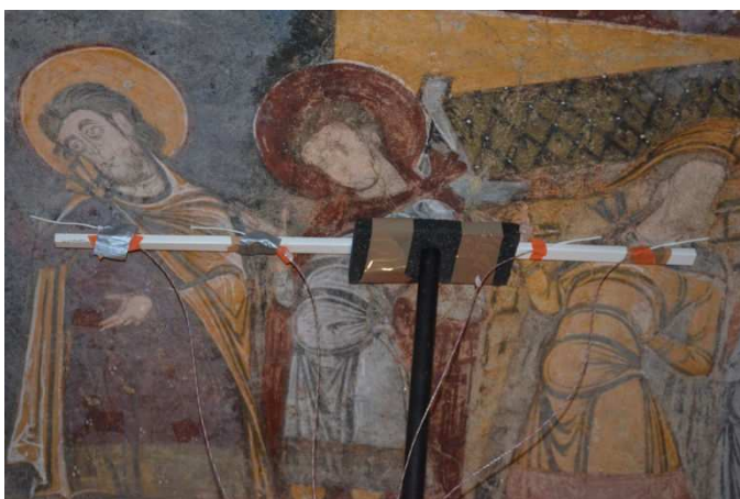
Figure 265: Instrumentation de la fissure. Les premiers capteurs sont placés à l'intérieur de la baguette blanche.
