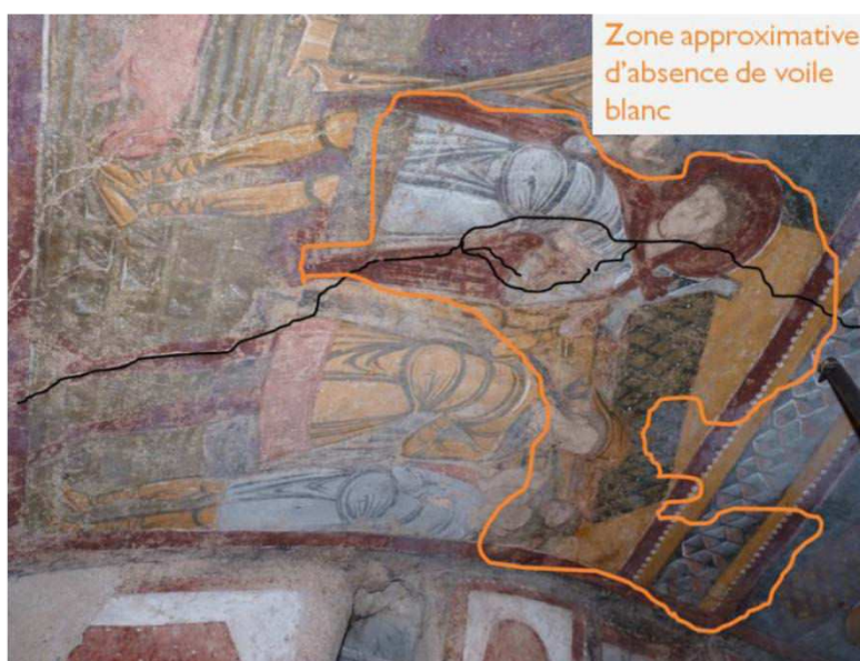
Figure 255 : Détail de la voûte de la crypte : fissure (en noir) et zone "saine", non recouverte de voile blanc
