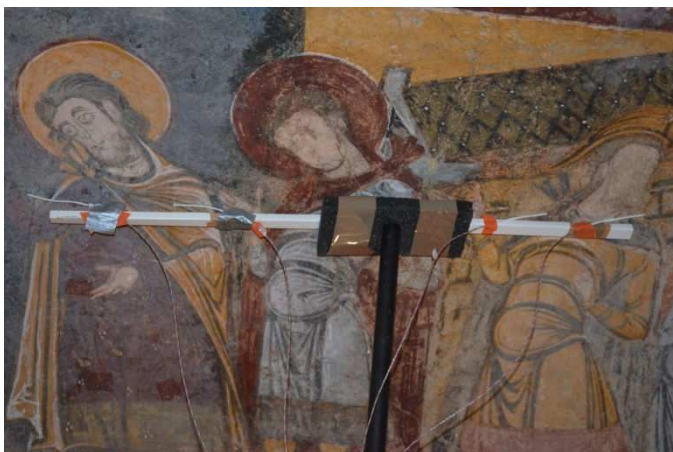
Figure 265: Instrumentation de la fissure. Les premiers capteurs sont placés à l'intérieur de la baguette blanche.
