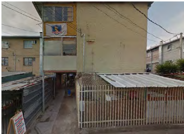
Población Pedro Lira, Sector Bajos de Mena, commune La Pintana. Ensembles de logements sociaux surpeuplés (2)
