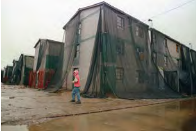
Logements COPEVA couverts en plastique, quartier El Volcán, commune de Puente Alto
