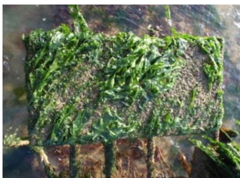
Figure 5-7 : Recouvrement de la surface des bétons par des algues (Foveau et al., 2015)
