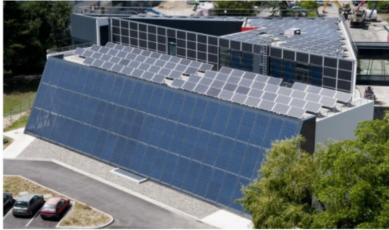
FIGURE 1.6: Façade et toit photovoltaïque du bâtiment Adream
