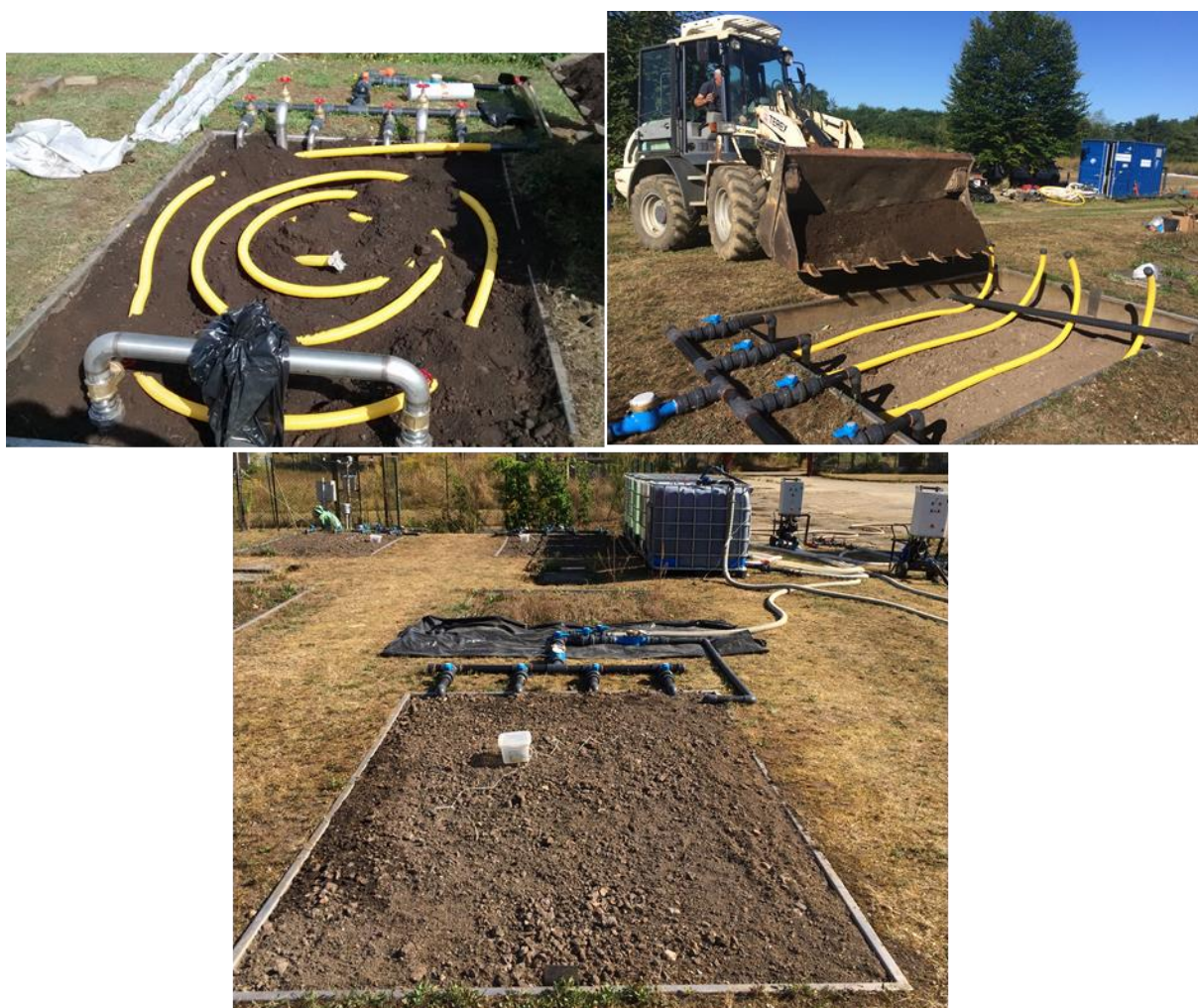
Figure 53 : Réseau de drains d'injection des oxydants en surface (en haut à gauche) et à mi-hauteur (en haut à droite) et parcelle lysimétrique prête à être traitée (en bas)
