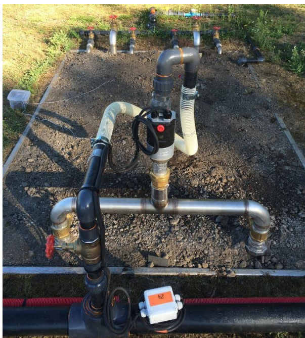
Figure 57 : Chauffage convectif des parcelles lysimétriques par injection d'air chaud dans deux tubes inox perforés placés au fond de la terre
