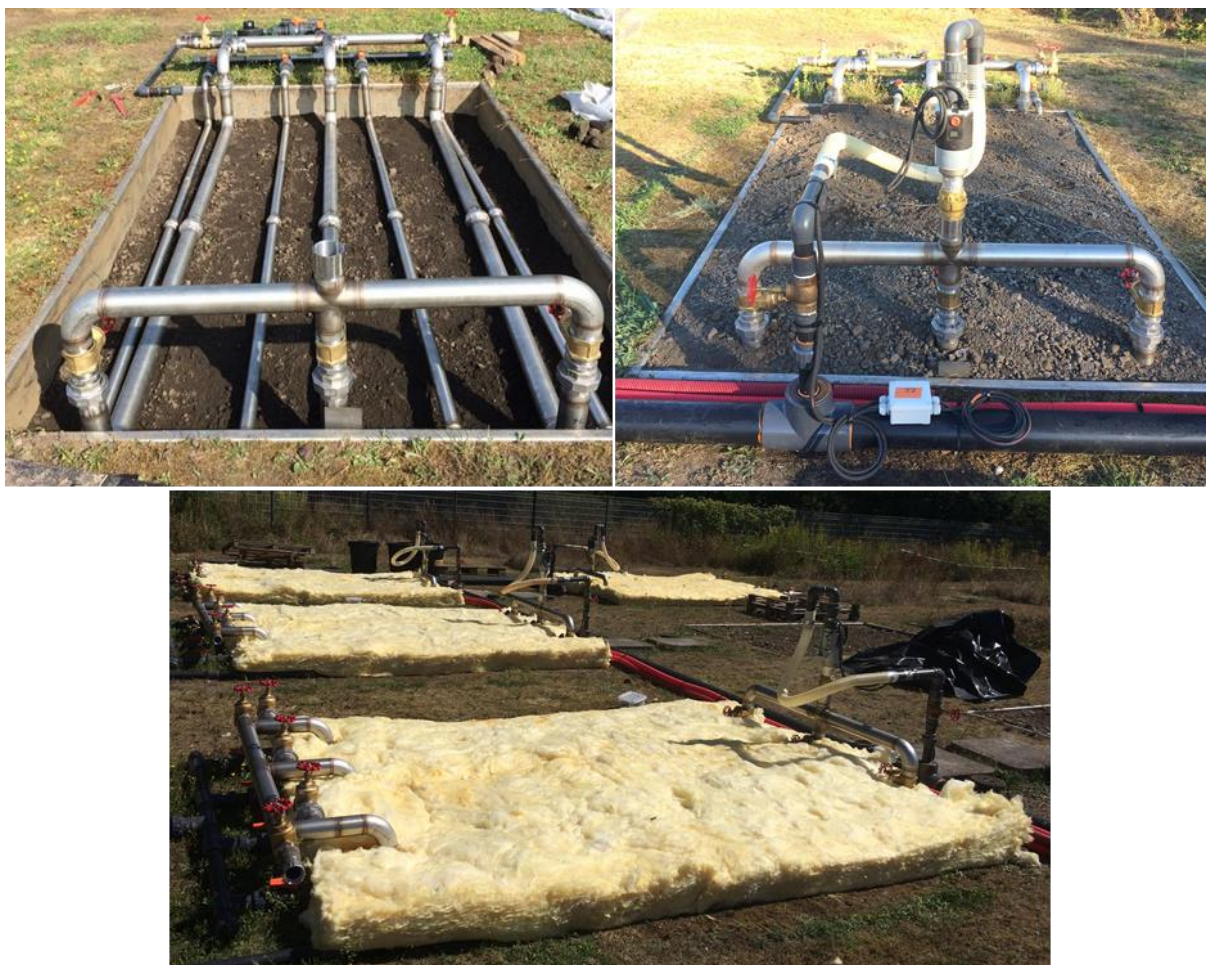
Figure 56 : Chauffage conductif par injection d'air chaud dans trois tubes inox placés à mi-hauteur de terre (en haut) et isolation thermique par pose de laine de verre en surface des parcelles lysimétriques (en bas)
