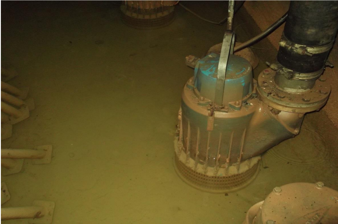
Eaux d'infiltration pompées à Cité. Juin 2013
