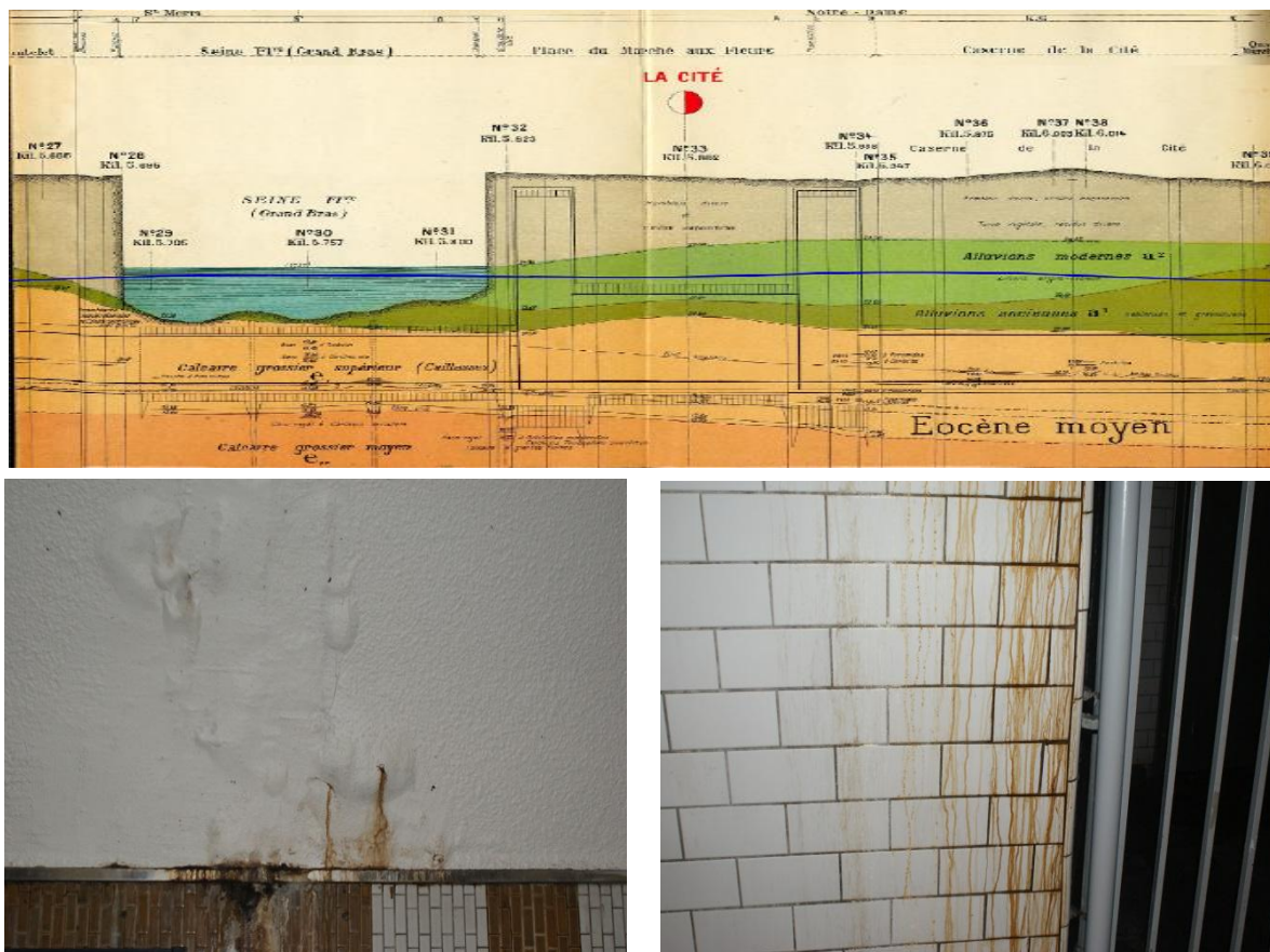
Figure 5 : Coupe géologique de la station « la Cité » et traces des infiltrations dans le tunnel de la station Cité. Juillet 2013.
