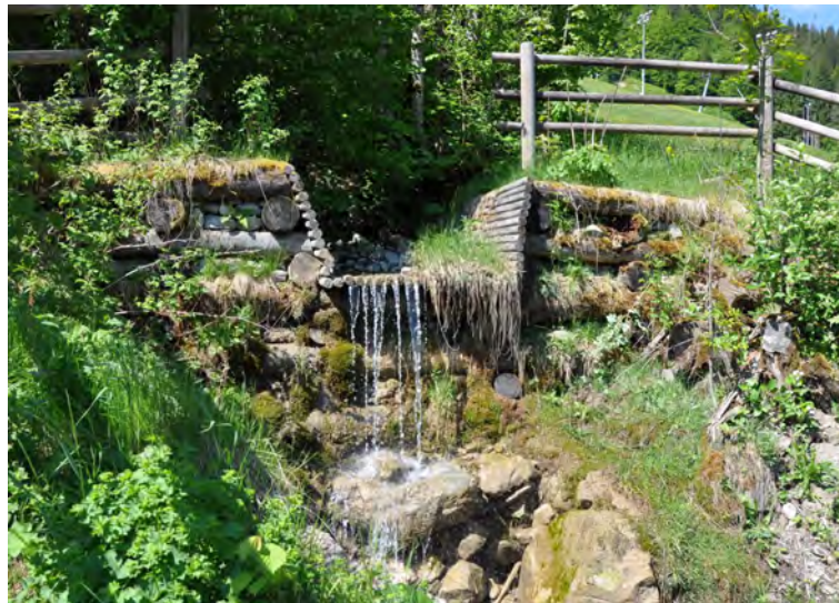
FIGURE 1.3 – Seuil de correction torrentielle en sapin. Morzine (Haute-Savoie). Crédit : IRSTEA
