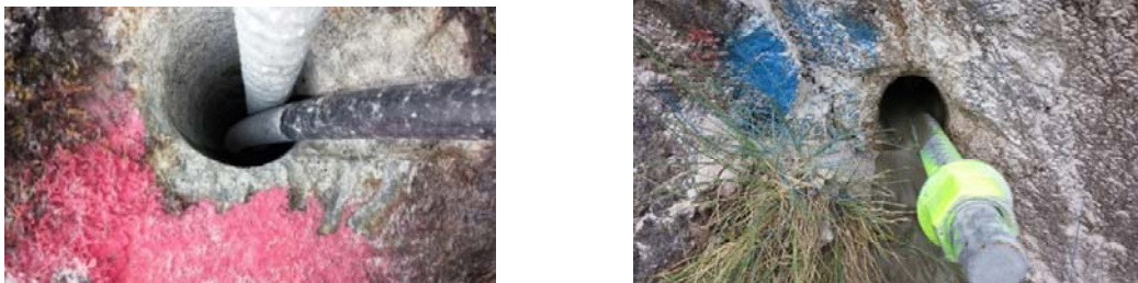
Figure 16. Exemples de position inadéquate de centreurs : a) barre excentrée en tête avant le scellement ; b) barre excentrée en tête après scellement.
