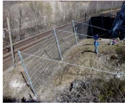
Figure 9 Ecran de filet pare-bloc dynamique (CEMAGREF, 2004)
