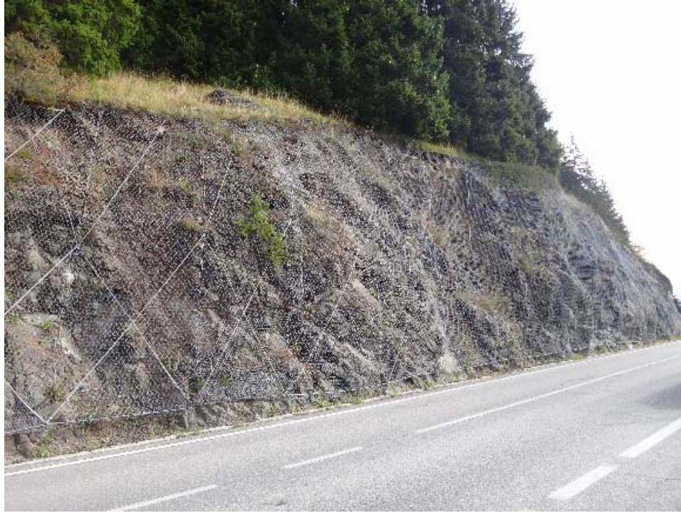
Figure 1 Grillage plaqué ancré (crédit photo : M.Bost)
