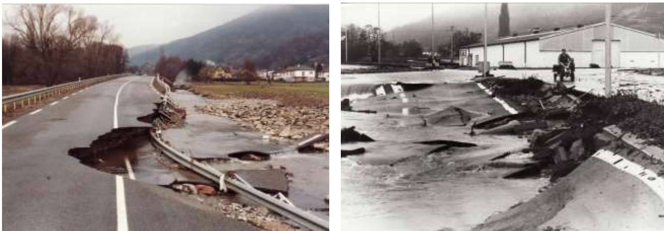
Figure 4 : « Pénétrante » (RD 430) détruite en février 1990 à Buhl (Sources : photo AMG 13W 10)
