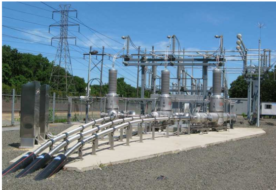
(a) Les trois câbles plongeant dans le sol sur 600 m (crédit : American Superconductor Corporation).
