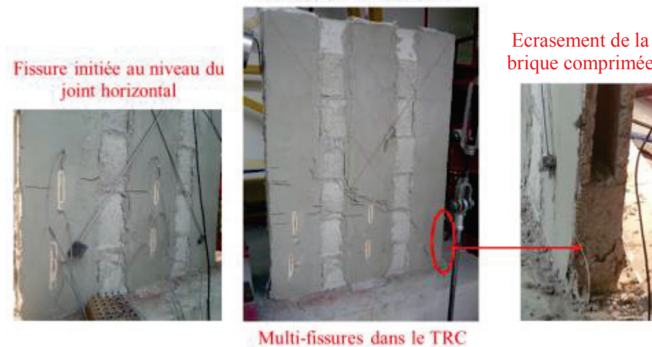
(b)- Rupture de type flexion- cisaillement du mur MRTRC2
