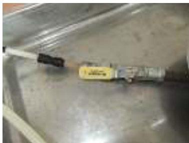
Ouvrir le robinet et vérifier l'étanchéité du bloc
