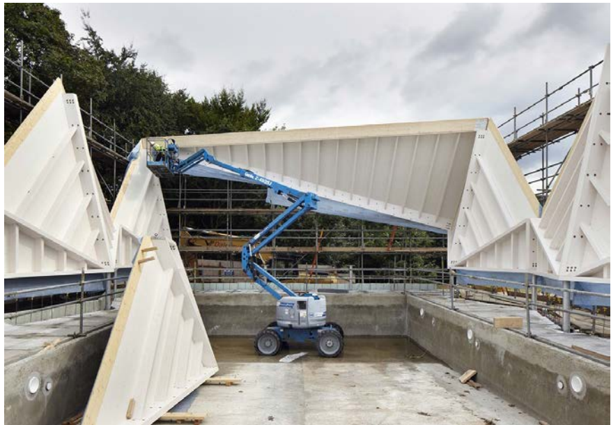
Figure 2.11 - Montage des panneaux à ossature formant la coque plissée qui recouvre la piscine. D'après (Hobhouse, 2015).
