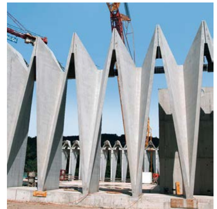
Figure 1.27 - Mise en place des éléments préfabriqués en béton, salle multisports, Windisch, Suisse, Livio Vacchini, 2005.
