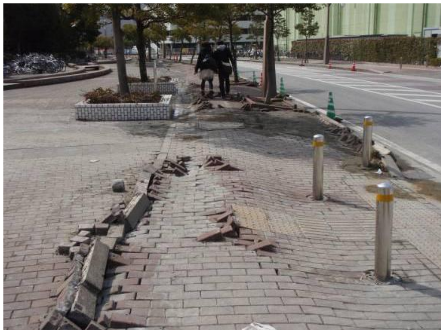
Source : Centre de la recherche de l'environnement du département de Chiba, Des dégâts de la liquéfaction, dans un terre-plein de la baie de Tokyo, provoqués par le tremblement de terre du 11 mars 2011, 15 mars 2011
