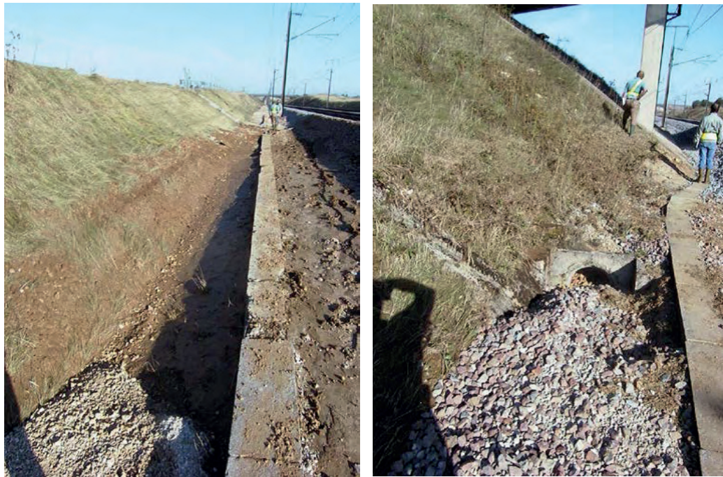
(a) Ecoulements d'eau et éléments solides collectés par les fossés (PAMS CAPOCCIONI et al. , 2015) (b) Drainage bouché par des éléments solides et présence de ballast issu du pied de la banquette (PAMS CAPOCCIONI et al. , 2015)
