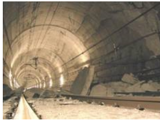
(b) Tunnel endommagé
