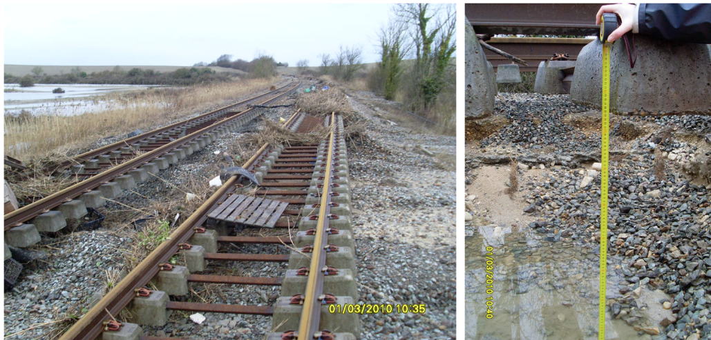
(a) Dégâts sur la ligne SNCF La Rochelle-Rochefort suite à la tempête Xynthia (b) Emportement du ballast et du remblai ferroviaire sur la ligne SNCF La Rochelle-Rochefort suite à la tempête Xynthia
