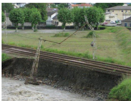
(a) Supports caténaire affaissés suite à l'emportement du remblai ferroviaire (source : SNCF)
