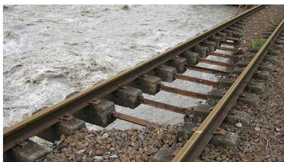
(b) Rails suspendus au-dessus du vide suite à l'emportement du remblai ferroviaire (source : SNCF)
