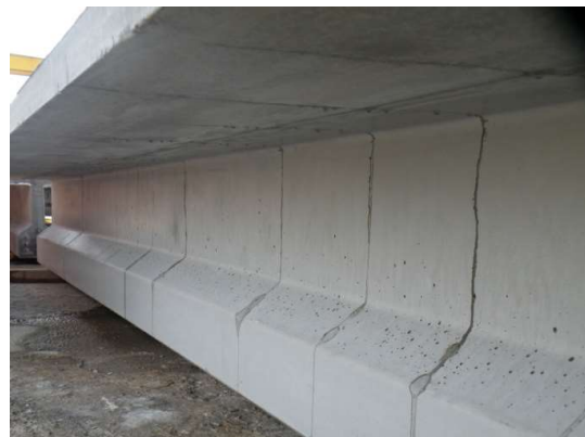
Percollation de l'eau de pluie dans les fissures de la table
