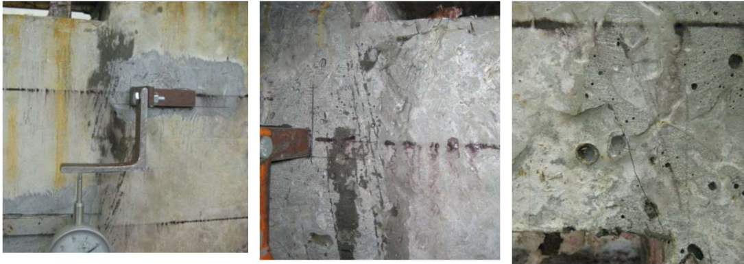
Figure 67: Profil de fissuration constaté sur les corps d'épreuve monolithiques non préfissurés
