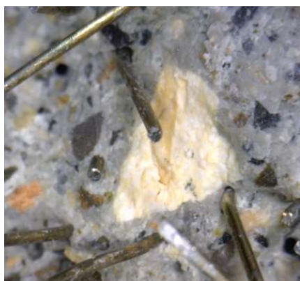
Granulat traversé par la fissure
