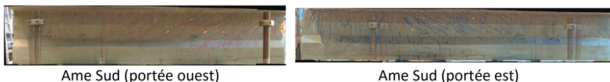
Figure 231: Relevé de fissure dans l'âme de la poutre BFUP B B
