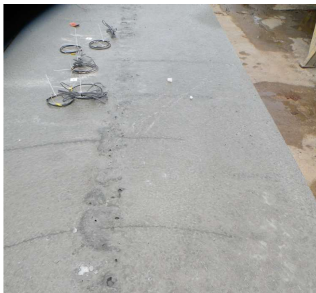
Fissuration de la table des poutres
