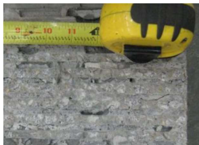
Figure 66: Vue d'une surface de reprise présentant des encoches (Crane, 2010)
