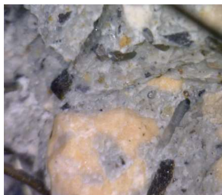
Granulat non traversé par la fissure
