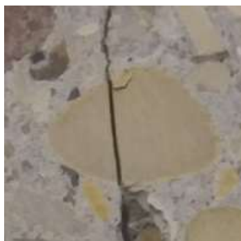
Figure 161: Granulat cassé après un essai de fendage dans un BO
