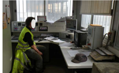
Centrale de pilotage du malaxeur et des pesées
