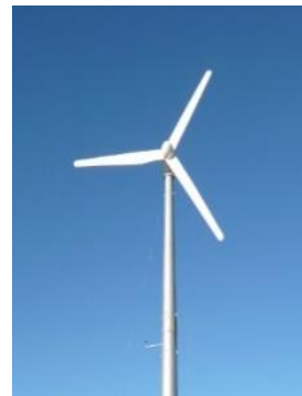
b. Eolienne à axe horizontale
