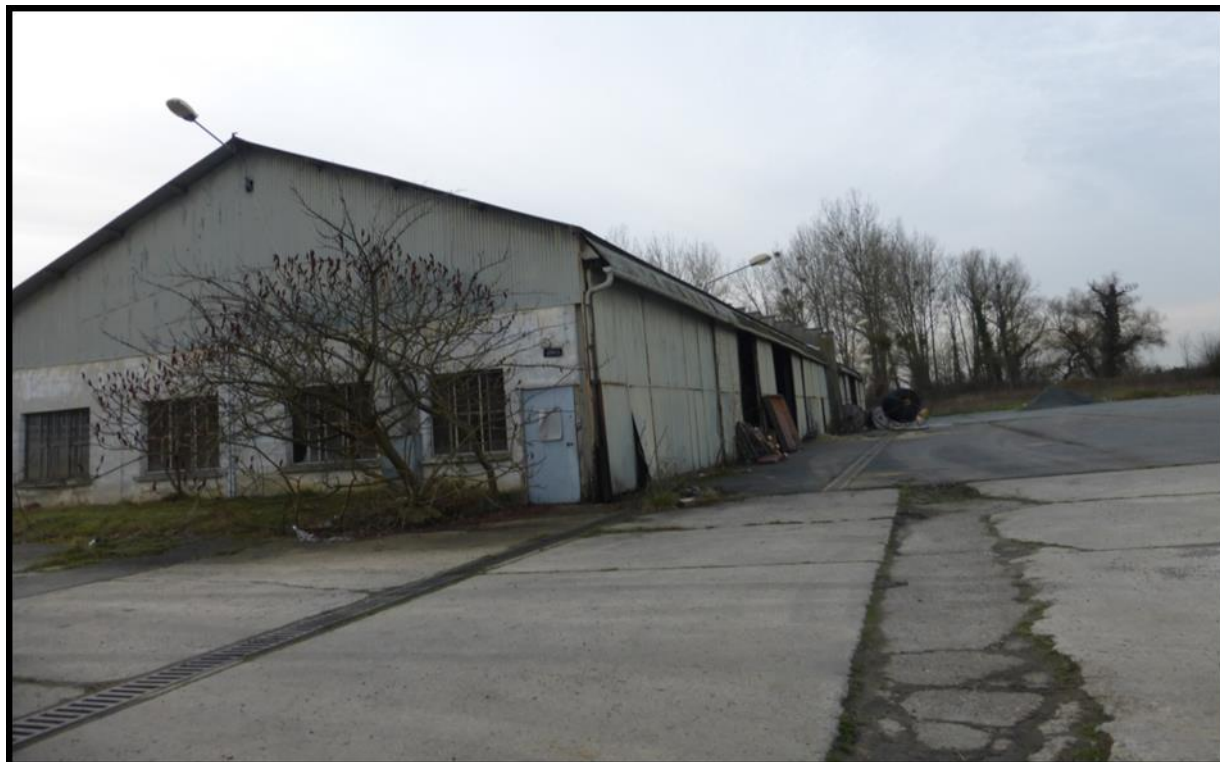
Illustration 21 : certains locaux techniques sont en très mauvais état et nécessiteraient de coûteuses réparations.
