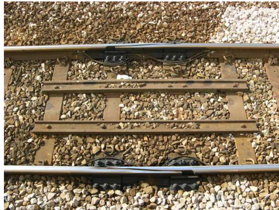
Figure 18. joints de dilatation sur une voie de Cornish Main Line, Angleterre
