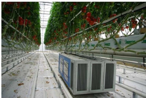
Figure 6: Déshumidificateur utilisé pour le contrôle d'humidité (source: http://www.nevo-therm.fr/deshumidificateur-de-serres-thermodynamique-giordano ).
